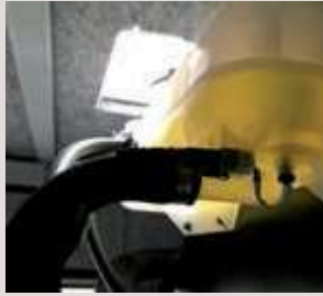
ALLARME LIVELLO LIQUIDO REFRIGERANTE WATER LEVEL ALARM
